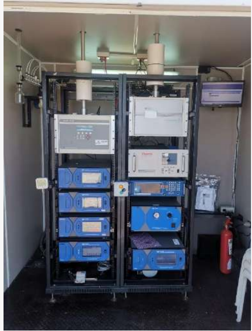
Estación de Monitoreo Referenciada
